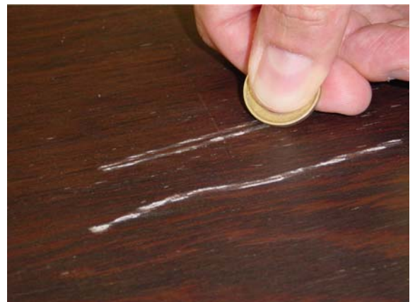
Abb. 2: Oberfläche mit schlechter Haftung nach Coin-Test
