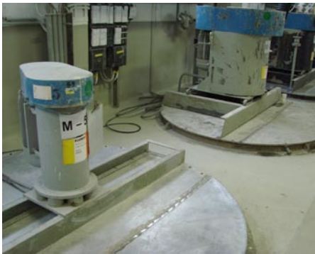
Tank und Mischanlage im Werk Wuppertal haben derzeit eine Kapazität von 400 t im Monat.
